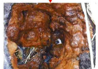
仕切弁内腐食状況
