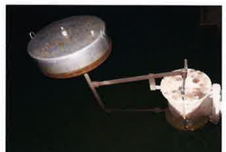
小泉4号水槽（定水位弁）
