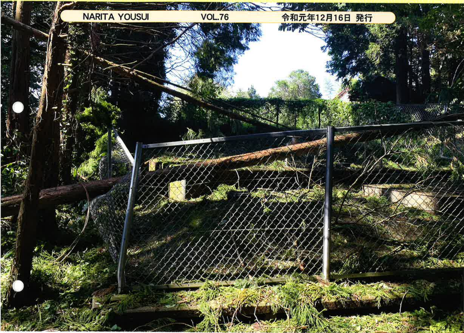
台風により施設のフェンスが被災している状況写真
