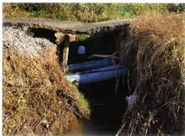
道路の洗掘により、埋設管露出状況
