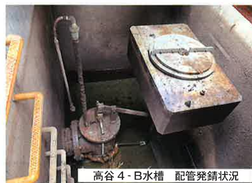
高谷4-B反復機場 配管発錆状況
