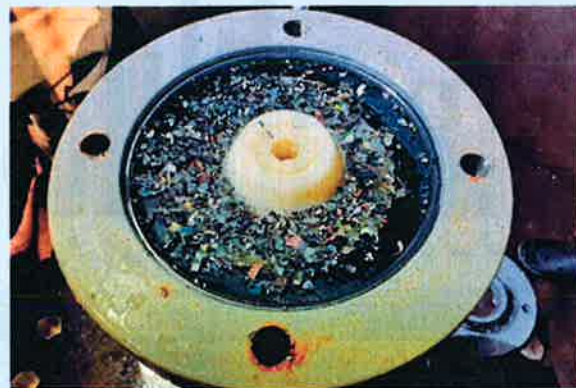
空気弁内ゴミ堆積状況
