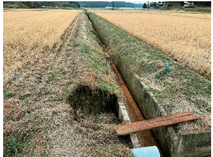
除草剤使用により陥没した法面
