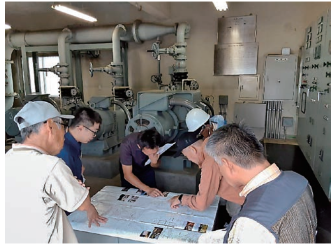
南部連絡拠点(芝山加圧機場)
