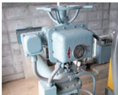
下総4号反復機場 電動仕切弁
