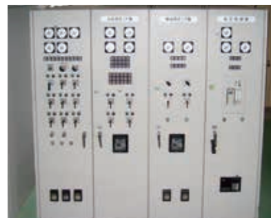
県営小泉揚水機場 制御盤
