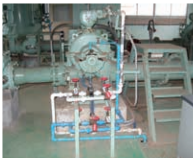
県営小泉揚水機場 ポンプ
