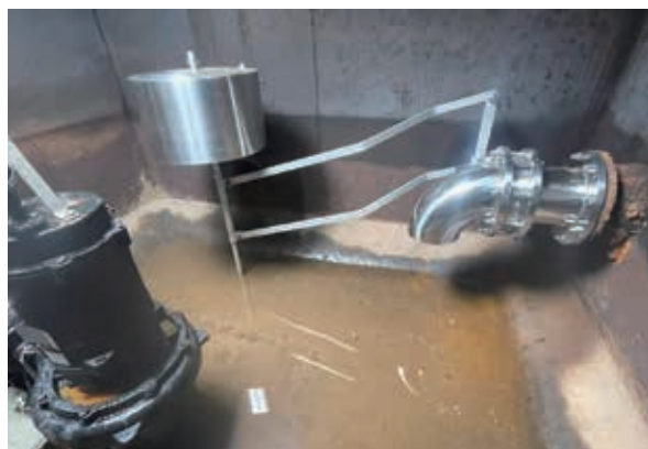
新設フロート弁
