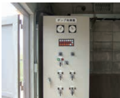
下総5号反復機場 制御盤
