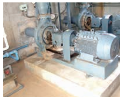
尾羽根川下流反復機場 ポンプ
