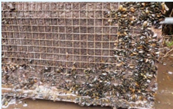
カワヒバリガイ付着状況(加圧機場フィルター)
