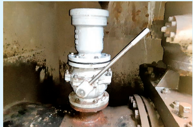
マンホール内空気弁
