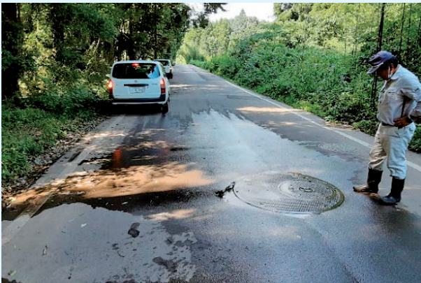
道路上マンホールからの漏水状況
