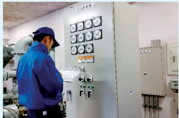
加圧機場点検作業
