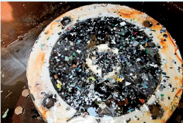
空気弁内ゴミ堆積状況
