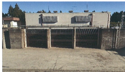
小泉揚水機場銅製スクリーン
