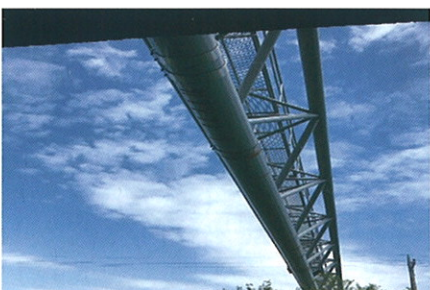
牛熊水管橋発錆状況
